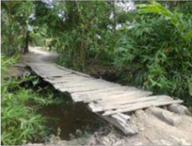
Hình: Cầu ván áp 6, xã Hòa Mỹ gần sập
